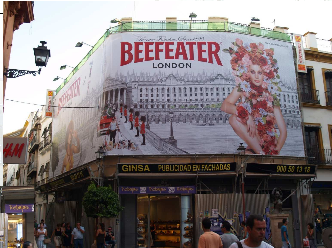
Calle Velázquez esq. Calle O ´ Donnell Detalle del andamio para dejar libre los escaparates de los comercios existentes.
