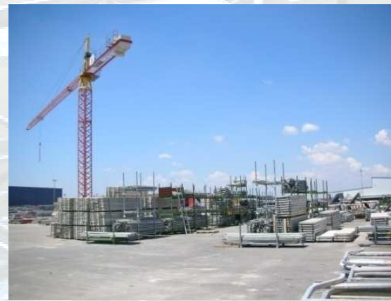
CAMPA DE ALMACENAJE
